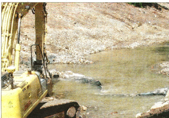
Tonnenschwere Steine wurden eingebaut. Im Bild sieht man die Entstehung einer Pendelrampe. Foto: Dietl
