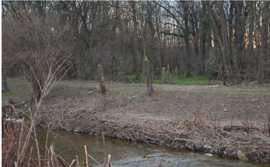
Abb. 6-10: Die Aussteckung der Querung des neuen Flusslaufes mit dem alten Lauf (zukünftige Flutmulde), Fkm. 24,76 (März 2013)
